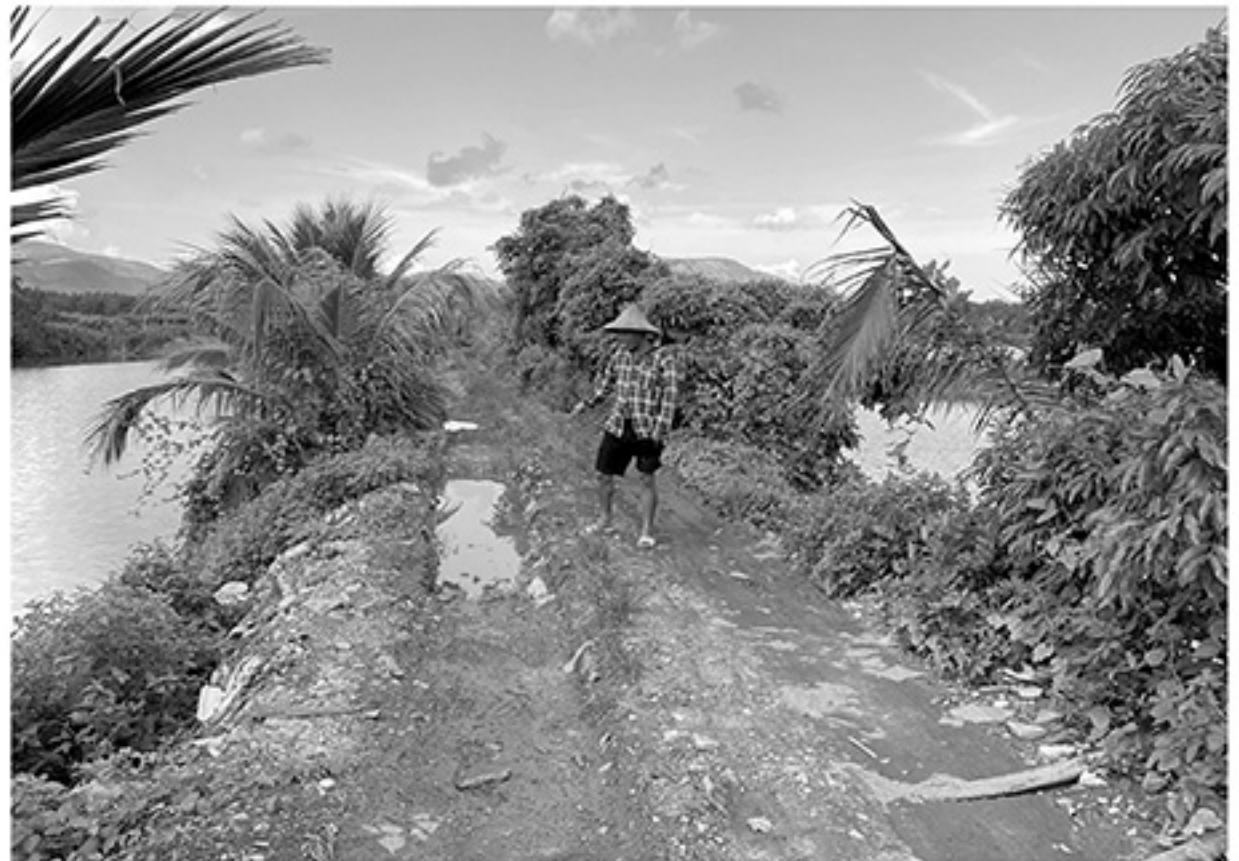
Nhiều khu vực mặt đê xuống cấp, ảnh hưởng không nhỏ đến việc lưu thông phục vụ dân sinh và công tác hộ đê khi có sự cố
